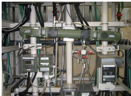
図5.2 ろ過水濁度の常時監視装置
